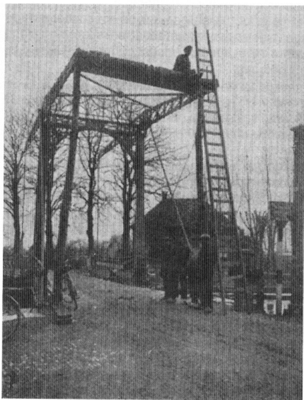
1924 – „Een vreeselijk auto-ongeluk heeft plaats gehad bij Epe, waarbij 2 personen het leven verloren. Een auto reed van de brug in de vaart. Op deze foto ziet men de zwaar beschadigde brug, die nu gerepareerd wordt.”
